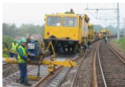
Longs rails soudés sur traverses béton
